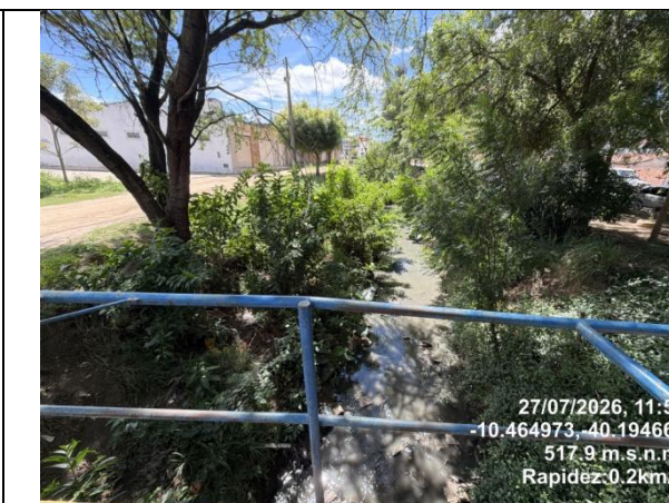
10- Vista da ponte sobre o Riacho do Alambique. Água com turbidez elevada, coloração escura e forte odor característico de aporte de esgoto sanitário.
