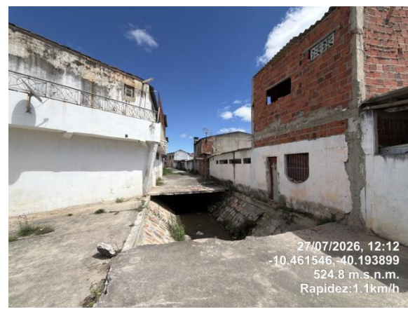
28 - Colapso da laje de cobertura do canal cujos escombros ficam depositados no leito impedindo o livre fluxo hídrico. Não ficaram constatadas placas de sinalização de advertência de perigo e técnicas de isolamento do local de modo a evitar acidentes. Edificações construídas nas margens do rio.
