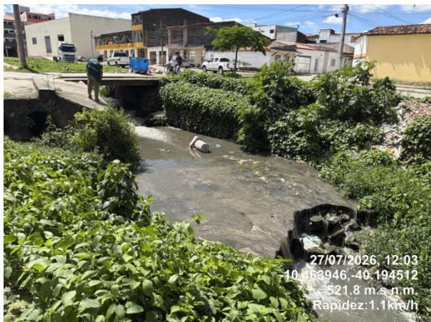
18- Despejo de esgoto sanitário in natura por meio de duas manilhas. Inspeção em tempo seco. Presença de vegetação nas encostas do canal revestido denotando falta de manutenção do equipamento público.
