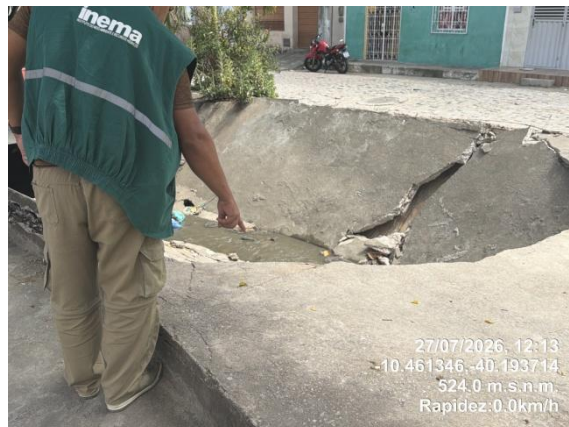
30- Imagem apresentando colapso na estrutura de concreto de cobertura do canal, cujos escombros estão depositados no leito do canal dificultando o livre fluxo hídrico. Não ficaram constatadas placas de sinalização de advertência de perigo e técnicas de isolamento do local de modo a evitar possíveis acidentes com transeuntes.
