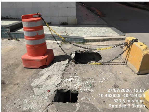
23 – Aberturas na laje da cobertura do canal apresentando risco de colapso e perigo a transeuntes.
