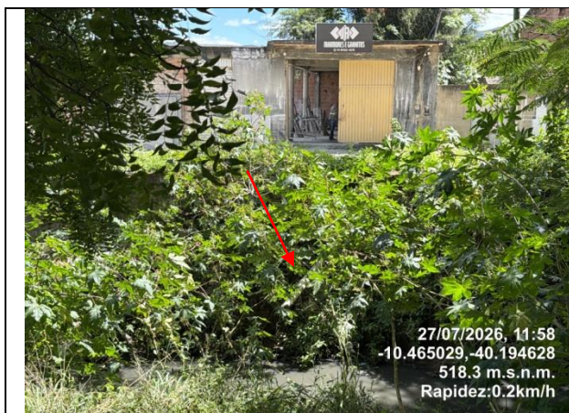
9- Cano de PVC realizando lançamento de águas residuárias no riacho do Alambique.
