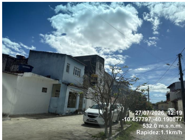
36 - Veículos estacionados sobre a laje de cobertura do canal sobrecarregando a estrutura. Residências construídas às margens do canal do Riacho do Alambique.
