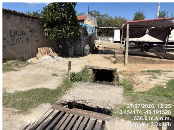
38 - Riacho do Alambique na Rua Carrapichel (Canal da Malária). Lava jato de veículos instalada às margem do riacho. Laje com estrutura danificada com ferragem aparente e oxidada, evidenciando falta de manutenção preventiva e corretiva do equipamento público. Presença de vegetação na estrutura de revestimento e falta de sinalização e isolamento cobertura desmornonada.
