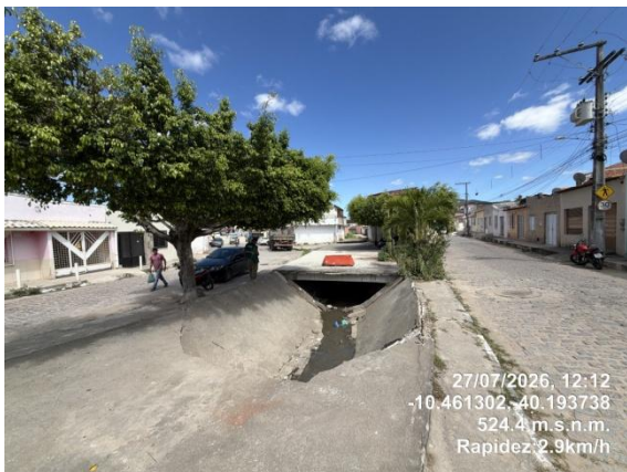
29 - Colapso na estrutura de concreto de cobertura do canal cujos escombros ficam depositados no leito impedindo o livre fluxo hídrico. Não ficaram constatadas placas de sinalização de advertência de perigo e técnicas de isolamento do local de modo a evitar acidentes.
