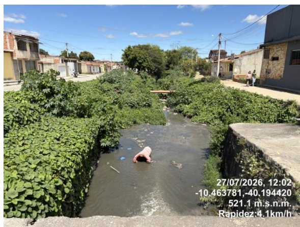
15 - Vegetação nas encostas do canal revestido denotando falta de manutenção do equipamento público.
