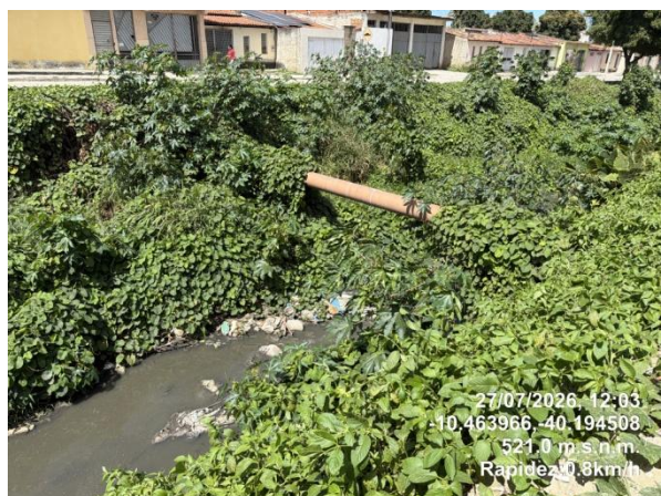
19 - Curso d'água com aporte de despejo de esgoto in natura residencial e presença de resíduos sólidos urbanos sobrenadante. Observa-se falta de manutenção do revestimento do canal pela presença de vegetação ao longo das vertentes do canal. Tubulação de água potável da Embasa atravessando de uma margem a outra.
