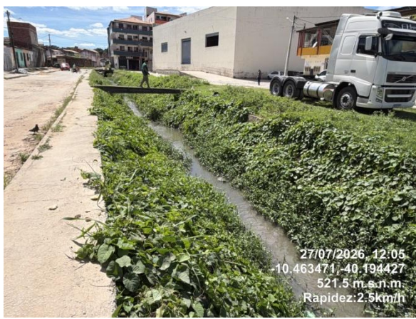
20- Observa-se falta de manutenção do equipamento público pela presença de vegetação nas vertentes ao longo do canal.
