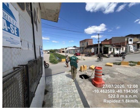
26- Laje de cobertura do canal por onde escoo o riacho do Alambique. Edificação construída à margem esquerda do Rio Alambique. Abertura na laje de cobertura do canal, evidenciando fadiga de material, falta de manutenção preventiva e corretiva do equipamento de drenagem urbana.
