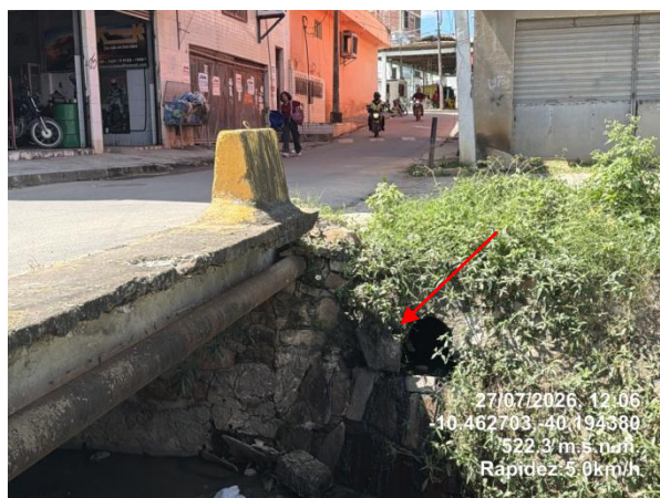
22 – Ponte sobre o Rio Alambique. Manilha realizando lançamento de águas residuárias em tempo seco provavelmente de esgoto sanitário. Odor no local bastante ativo e característico de esgoto sanitário. Observa-se falta de manutenção do revestimento do canal com o crescimento de vegetação.
