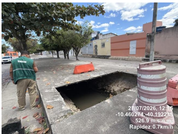
31 - Imagem evidenciando colapso na estrutura de cobertura de concreto do canal do riacho do Alambique. No local ficaram constatados cones para sinalização e isolamento.
