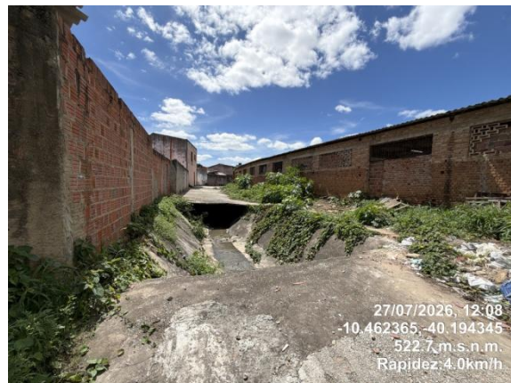
24- Imagem evidenciando colapso da laje de cobertura do canal cujos escombros estão depositados no leito do riacho dificultando o livre fluxo hídrico. Presença de resíduos sólidos urbanos dispostos às margens do canal. Pela disseminação de vegetação na estrutura do canal fica evidenciada a falta de manutenção preventiva e corretiva do equipamento público de drenagem urbana. Raízes de vegetação podem afetar estruturas de concreto e alvenaria.
