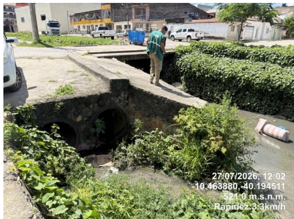
17 - Despejo de esgoto sanitário in natura por meio de duas manilhas. Inspeção em tempo seco. Presença de vegetação nas encostas do canal revestido denotando falta de manutenção do equipamento público.
