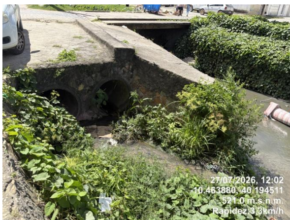
16- Despejo de esgoto sanitário in natura por meio de duas manilhas. Inspeção em tempo seco. Presença de vegetação nas encostas do canal revestido denotando falta de manutenção do equipamento público.
